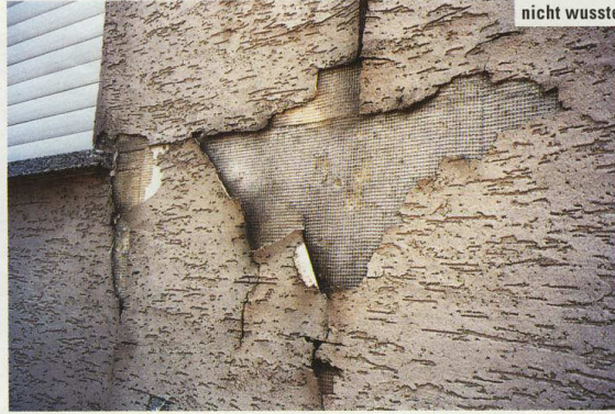
nur weil ein Handwerker nicht wusste, was er tat
